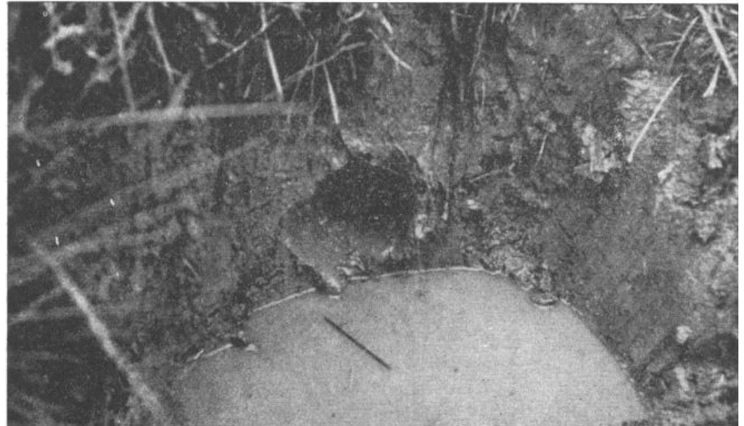
Zona de descarga de um tubo de drenagem em funcionamento
